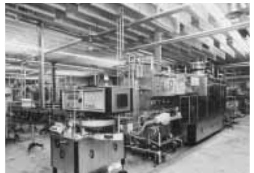
Baffles en panneaux acoustiques de laine minérale dans une entreprise produisant des boissons (installation de remplissage).
